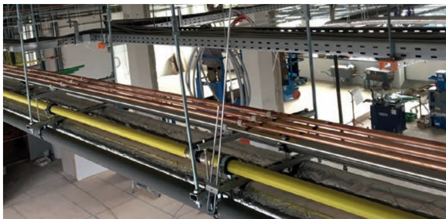
Alle leidingen worden ordelijk en veilig geplaatst onder het plafond
