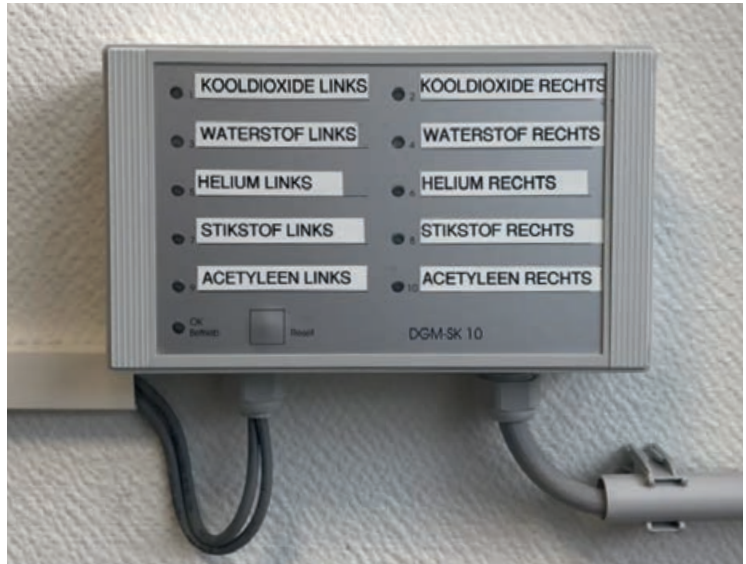
Controlepaneel voor de vijf verschillende gassen
